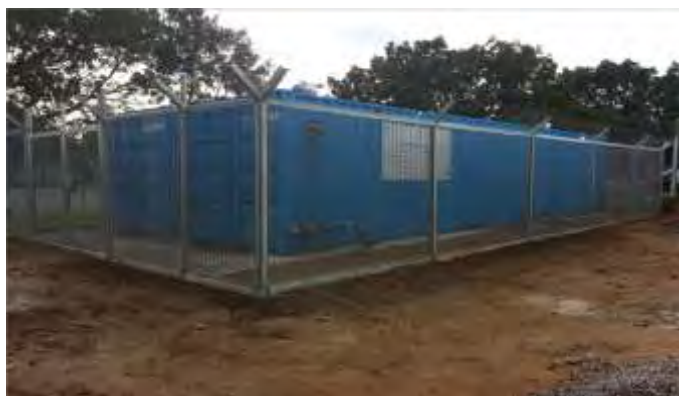
Figure 46: Stellenbosch Containerised WTW – Van der Stel
