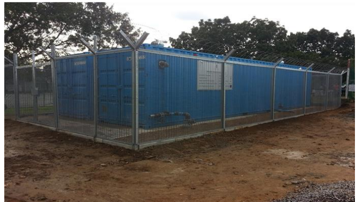
Figure 41: Stellenbosch Containerised WTW – Van der Stel
