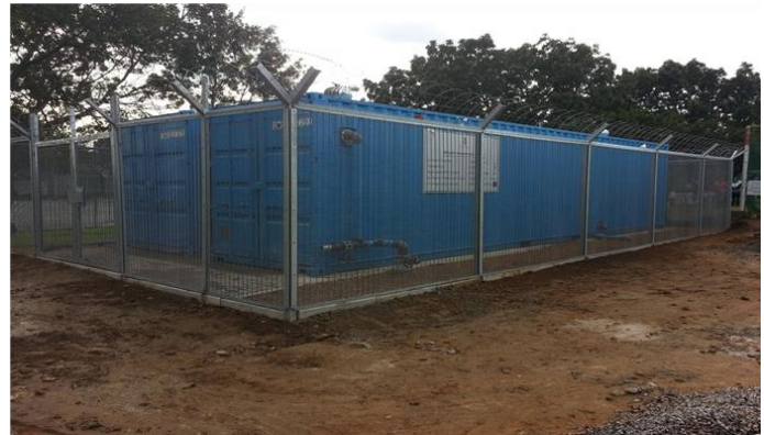
Figure 46: Stellenbosch Containerised WTW – Van der Stel
