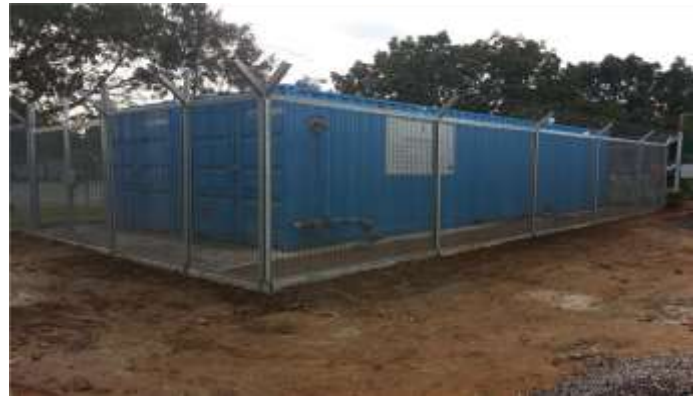
Figure 42: Stellenbosch Containerised WTW – Van der Stel
